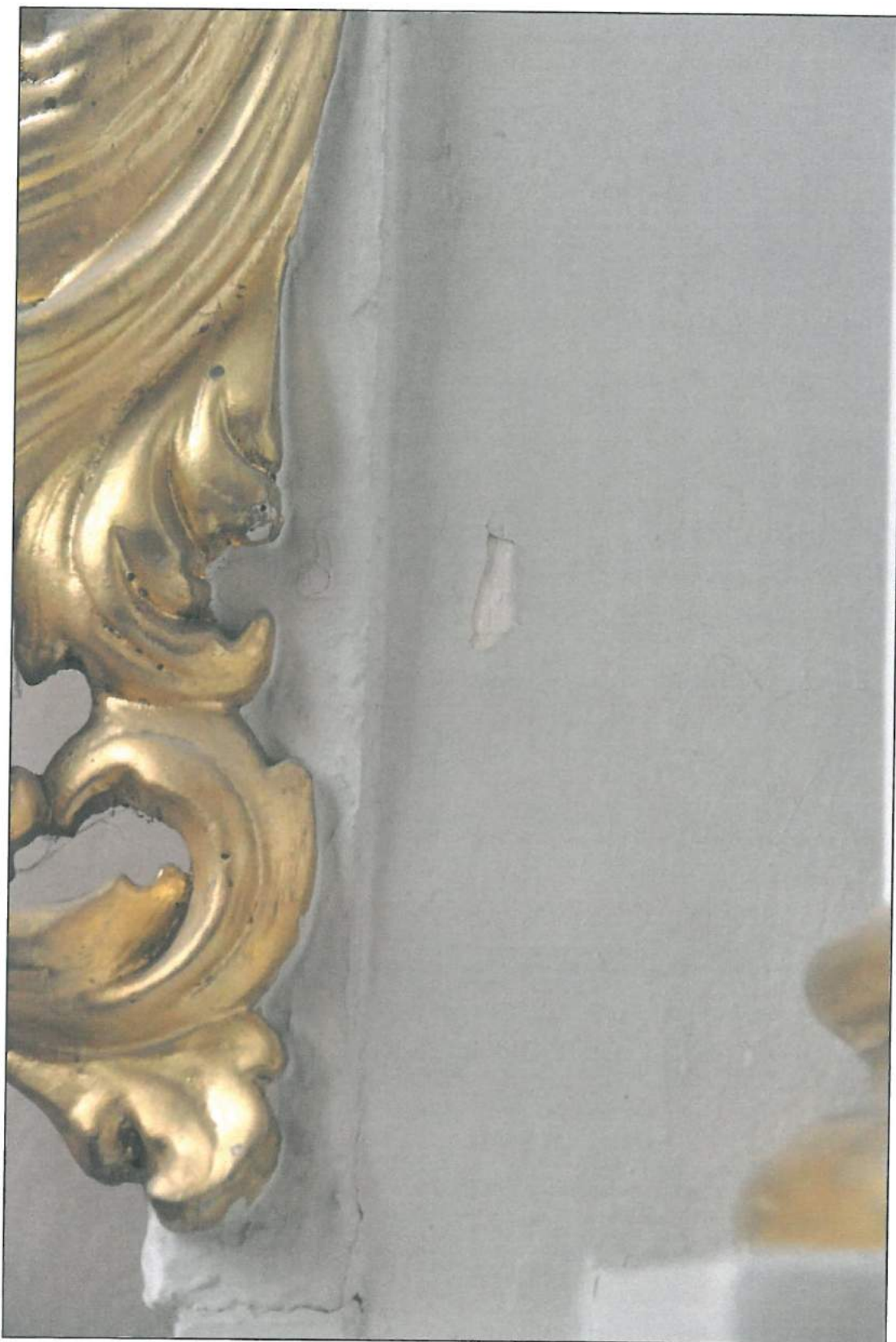
Fot.16. kościół parafialny p.w. św. Doroty w Grochowych. Ołtarz boczny (w skrzydle lewym transeptu) p.w. Św. Alojzego Gonzagi. Detal, fragment nastawy przy uszaku: widoczny stan zachowania powłok malarskich: złuszczenia, spęcherzenia. Stan z 15.02.2018 r.
