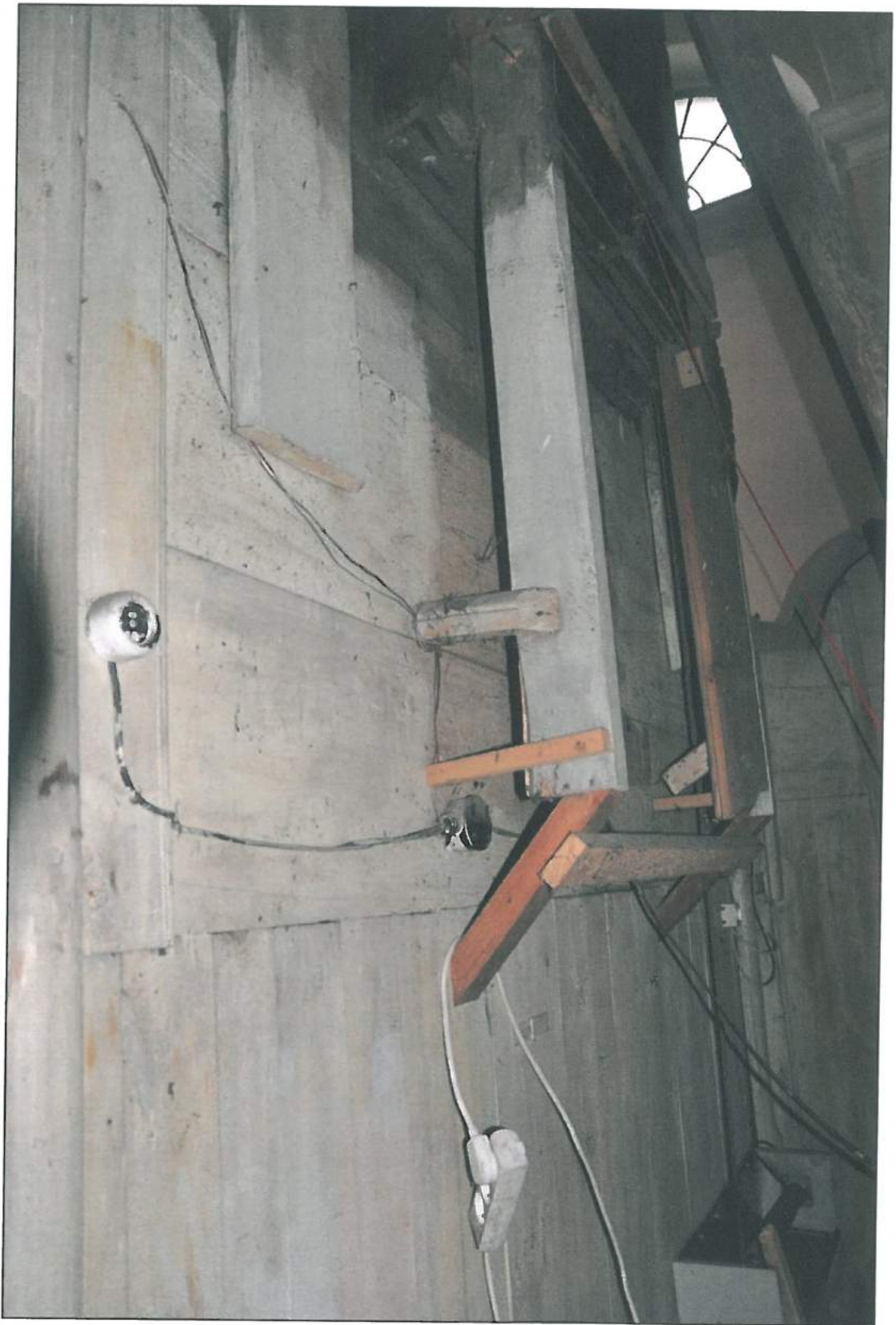
Fot.8. kościół parafialny p.w. św. Doroty w Grochowych. Ołtarz główny. Fragment odwrocia ołtarza. Widoczny stan zachowania drewna i otwory wylotowe po drewnojadach. Stan z 15.02.2018 r.
