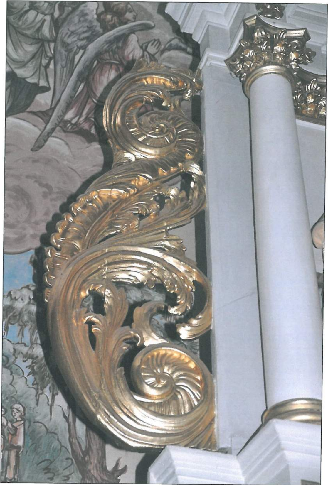
Fot.4. kościół parafialny p.w. św. Doroty w Grochowych. Ołtarz główny. Detal: uszak z widocznymi pęknięciami wyłożony szlagmetalem. Stan z 15.02.2018 r.
